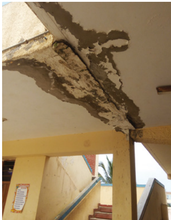
IE Cristo Rey ubicado en el distrito José Leonardo Ortiz, provincia Chiclayo. Se observa infraestructura del balcón dañada.
